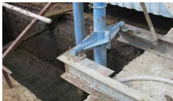
Fig. 67. Fosă septică cu canal de aducție și gură de evacuare a dejecțiilor cu pompa
