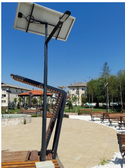
Figura nr.50 Echiparea stâlpilor de iluminat public cu panouri solare
